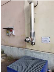
Attacco Serbatoio Urea Avanfossa - Area 5
